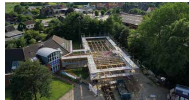
Der Blick von oben zeigt die Dimensionen des Neubaus: Der Übergang zwischen Alt- und Neubau sowie die rechteckige Form sind bereits klar erkennbar. Die Bauarbeiten schreiten zügig voran.
