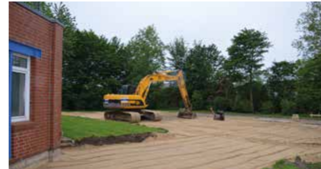
Dorum. Mai 2016: Die Vorarbeiten laufen an. Wo vorher Rasen und Teile des Parkplatzes waren, leuchtet jetzt heller Sand.
